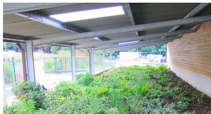
72 000 m 3 /h traité sur 135 m 2 de biofiltre planté
