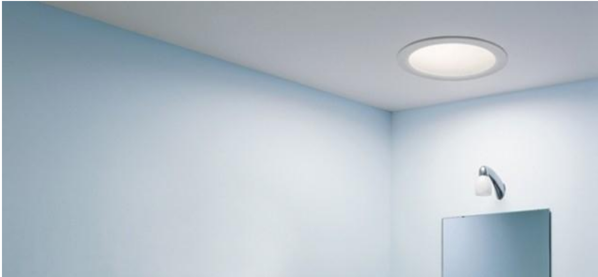
Figure 26 : Photographie d'un conduit de lumière naturelle, de jour
