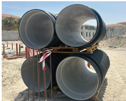
Conduite du puit canadien de 800 mm de diamètre
