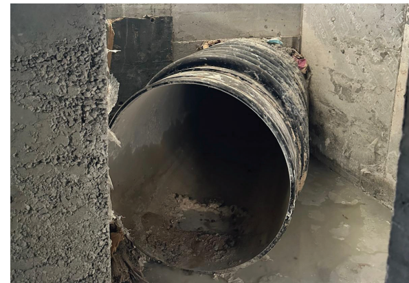
Sortie d'air du puit canadien dans le bâtiment, niveau RDJ
